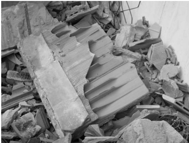
Crollo della gronda
