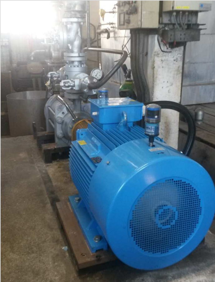
Installazione nuova pompa con motore SuPremE
