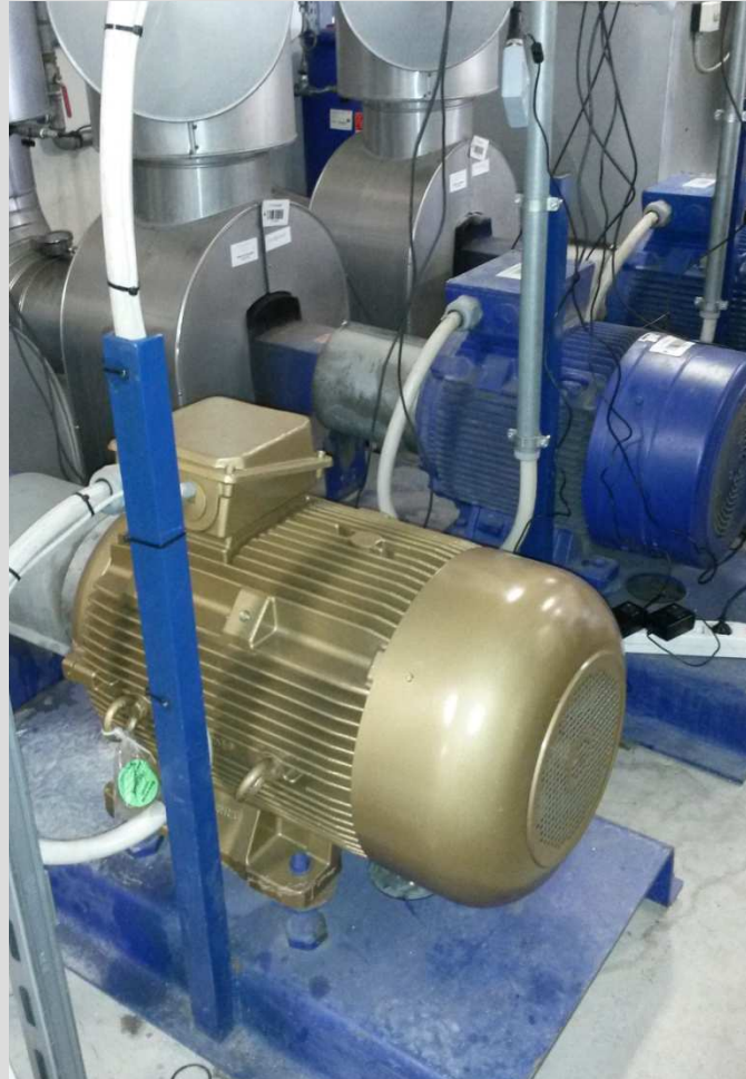
Tipico Installazione di n.1 SuPremE + PumpDrive S
