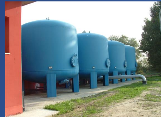
Filtri a sabbia impianto post-trattamento GIDA
