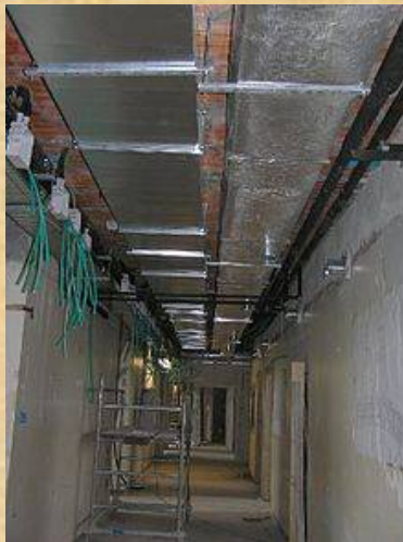
Canalizzazioni aerauliche installate a soffitto durante la ristrutturazione di un reparto ospedaliero
